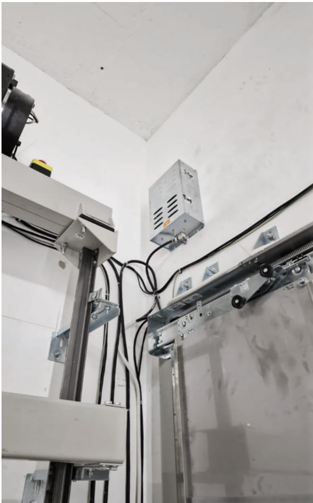
Fot. 7 Przeciwwaga z przeniesieniem na ścianę boczną pozwala na zwiększenie powierzchni szybu i montaż większej kabiny, archiwum Global Lift Polska
